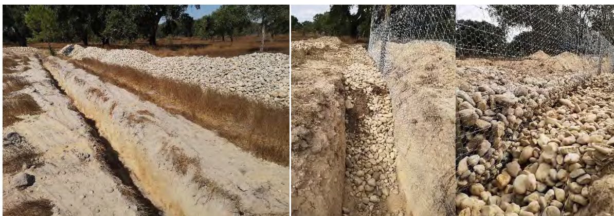
Figura 108. Vala para enterramento rede e enrocamento no cercado construído pela ANPC na Companhia das Lezírias.
