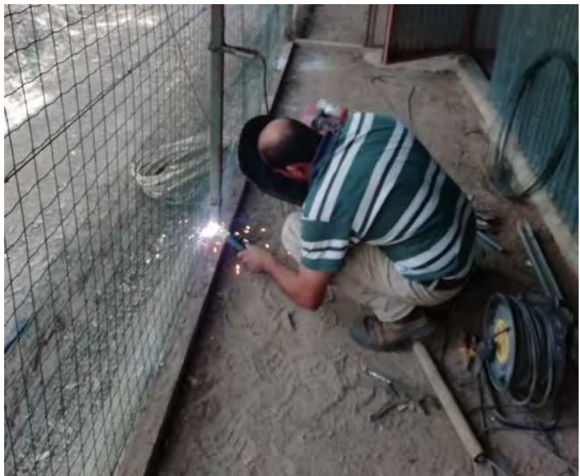
Daniel Ramos (na foto a soldar) e Fábio Abade dos Santos estiveram no dia 19 de setembro de 2019 a efetuar a aplicação das janelas.
